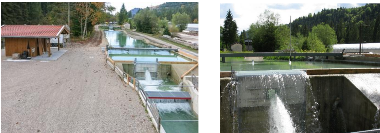
Abb. 5: Prototypanlage mit Technikgebäude (li.), Überfallströmung mit Abstiegsfenster (re.)
