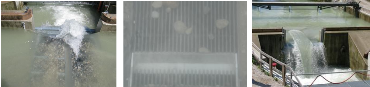
Abb. 7: Geschiebespülung mit Unterstützung der Rechenreinigung
